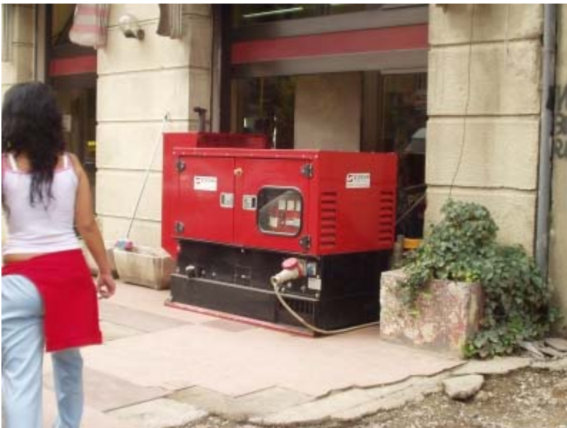
El-generator i sving i Tirana under strømudfald. September 2005. Foto: Bjørn Andersen
